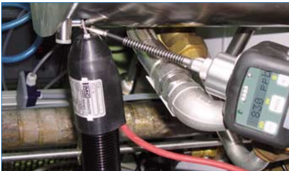
Figure 11. Exemple de recherche de fuites sur une machine industrielle
